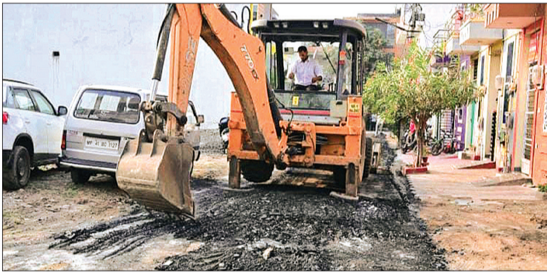
व्यय पर पुनः निर्माण करने हेतु निर्देशित किया गया। निगम आयुक्त दलीप के निर्देशन में चल रहे निर्माण कार्य या किये जा चुके निर्माण कार्य की संधारण समयावधि में किये गये सड़क निर्माण या निगम के अन्य निर्माण कार्यों में कमी पाई जाती है या सुधार कार्य होना है उन कार्यों को ठेकेदार के स्वयं के व्यय पर कार्य कराने के निर्देश आयुक्त ने विभागीय अधिकारियों को दिये। ठेकेदार द्वारा संधारण समयावधि के कार्यों में सुधार कार्य नहीं किया जाता है तो संबंधित ठेकेदारों की जमा अमानत राशि राजसात कर ब्लेक लिस्टेड करने की कार्यवाही भी की जावेगी। कार्यवाही के दौरान वार्ड पार्षद प्रतिनिधि रूपेश वर्मा, निगम उपयंत्री भूमिका जैन व वार्डवासी उपस्थित रहे।
